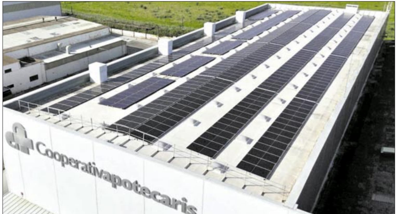
Los 425 paneles solares instalados en la Cooperativa d'Apotecaris proporcionan una potencia de 223,15 kWp y una producción solar anual de más de 300.000 kWh.
