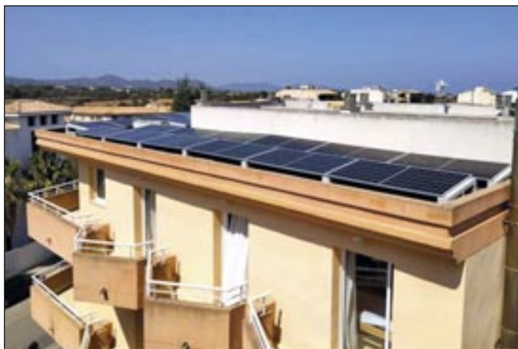
El complejo sanitario de Llevant estrenó instalación solar fotovoltaica en 2022.
