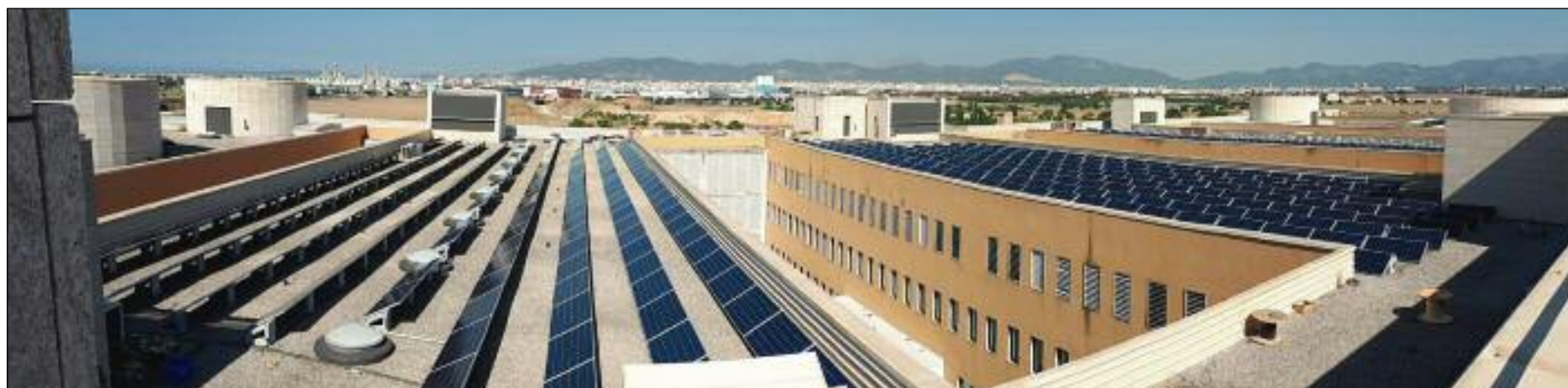
Imagen de la zona donde se ubican las placas solares.
